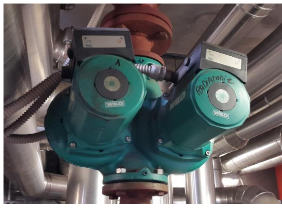
Circolatore da sostituire
