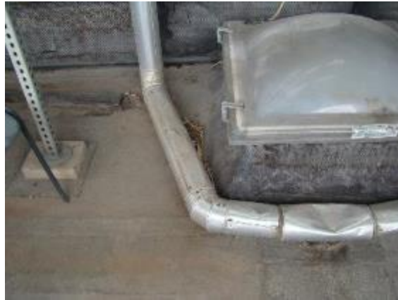
Tubazione da spostare
