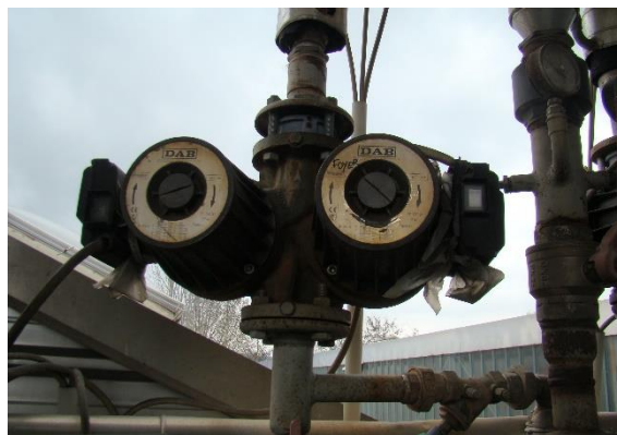
Circolatore da sostituire
