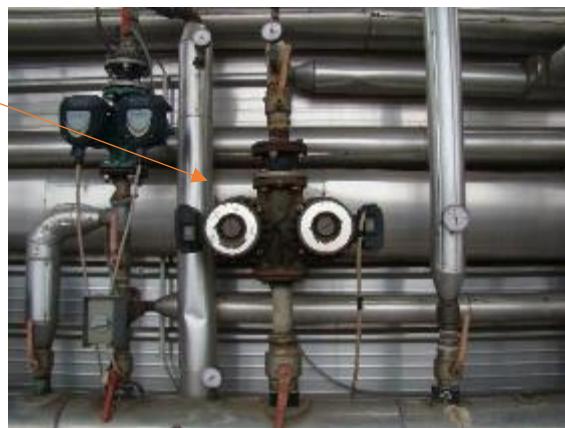
Circolatore da sostituire
