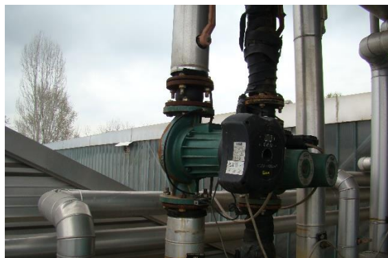
Circolatore da sostituire
