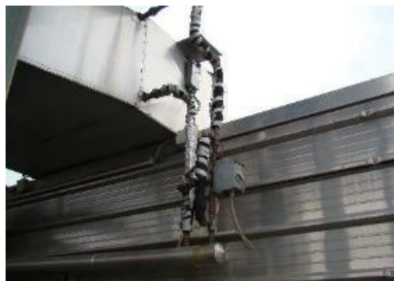
Valvola motorizzata batteria di post-riscaldamento
