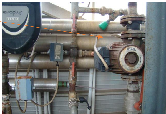
Circolatore da sostituire
