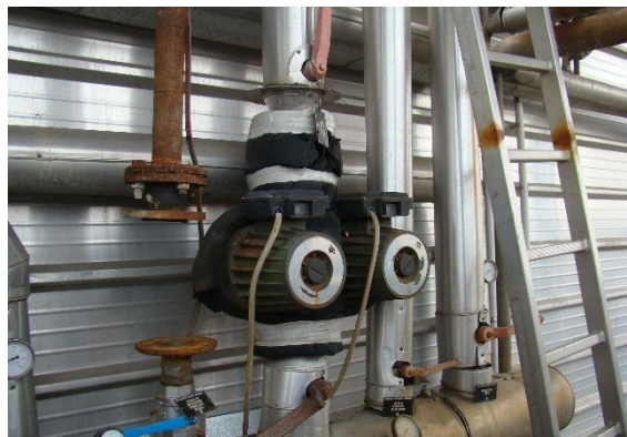
Circolatore da sostituire
