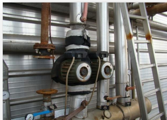
Collettore distribuzione acqua refrigerata
